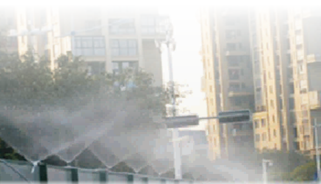
围墙（挡）顶端设置喷淋降尘系统
